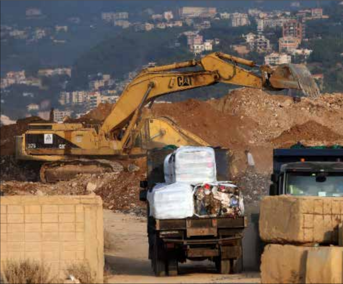
شاحنات تنقل النفايات من بيروت إلى موقع الكوستا برفا حيث تجري أعمال حفر في الأرض (هيثم الموسوي)
